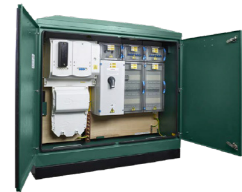
▲ EV feeder pillar.
